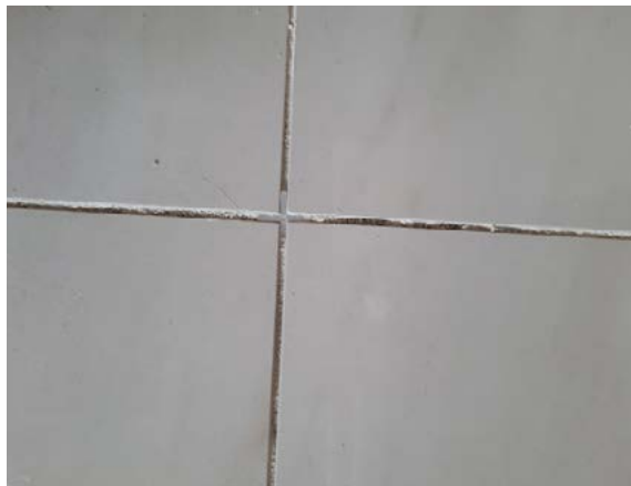
ورود گرد و خاک و نخاله‌های ساختمانی به درون بندها
