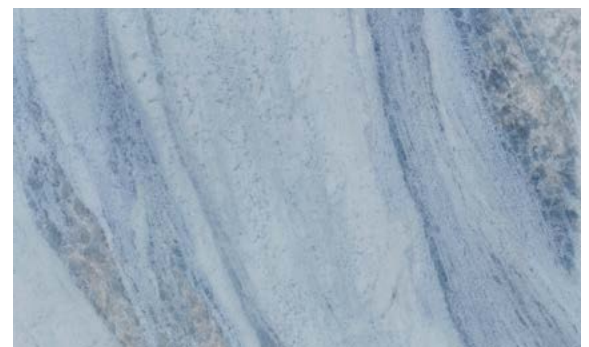
نتیجه حاصل از بندکشی نامناسب
