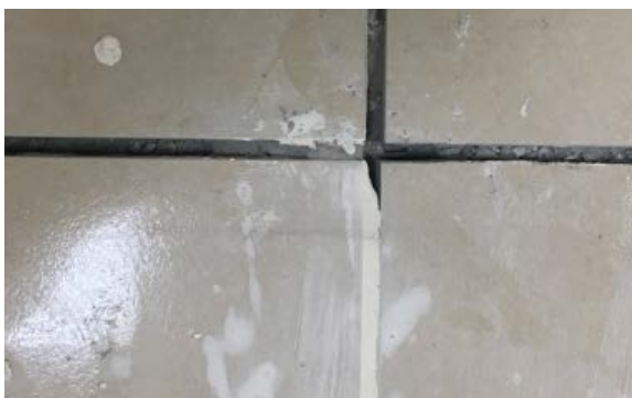
ترک خوردن و ریختن ماده بندکشی در اثر پر شدن ناقص بندها از ماده بندکشی
