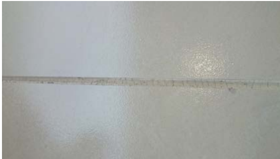
ترک‌های ایجاد شده در بند سرامیک، ناشی از انقباض دوغاب سیمان
